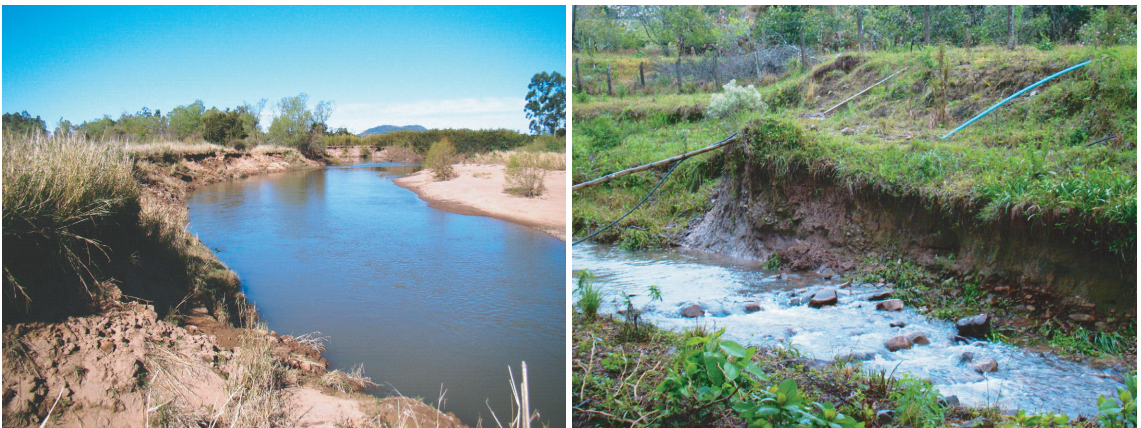
Figura 7: Focos de erosão e perda de estabilidade das margens de cursos de água da região. (Fotografias: Miguel Durlo)
