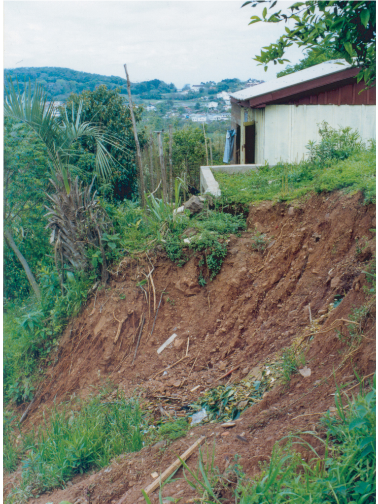
Figura 11: Depósito coluvionar de encosta da Serra Geral, na Vila Bilibio, sobre o qual foram construídas casas de moradia. (Fotografia: Pedro Sartori, 2000)
