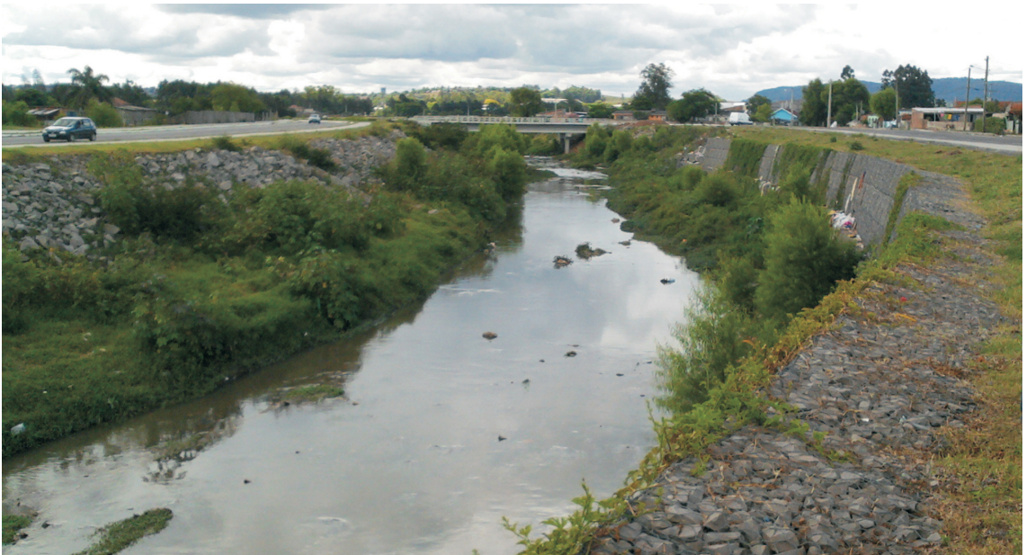
Figura 9: Gabiões sendo recobertos pela vegetação no arroio Cadena, Santa Maria, RS. Fotografia: Alexandre Dal Forno Mastella
