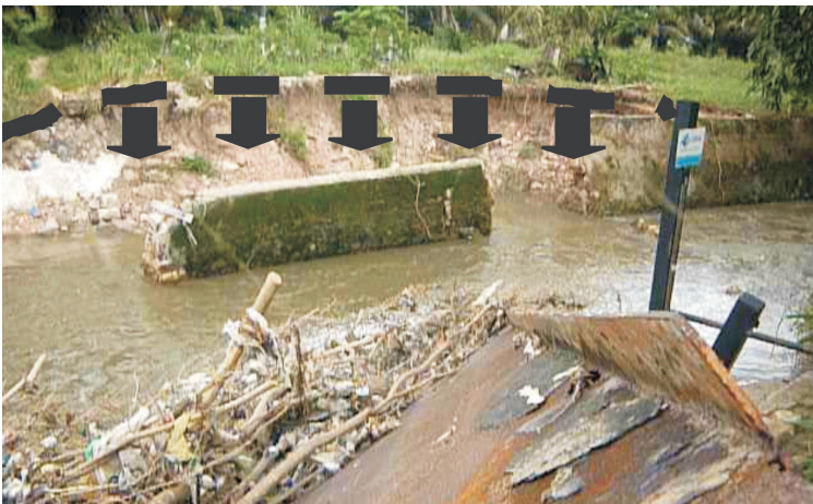
Figura 6: Foto do Igarapé do Mindu, na seção de réguas, onde se vê área da planície fluvial retomada pelo rio a despeito do canal de concreto e ponte que foi destruída pela enxurrada
