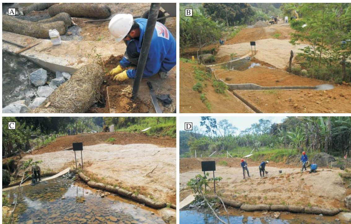
Figura 17: Aplicação de biorretentores e mudas nas alas do cinto basal saliente (a). Vista geral do sistema de drenagem no talude (b). Aplicação de biorretentor, biomanta e mudas na margem direita (c, d).
