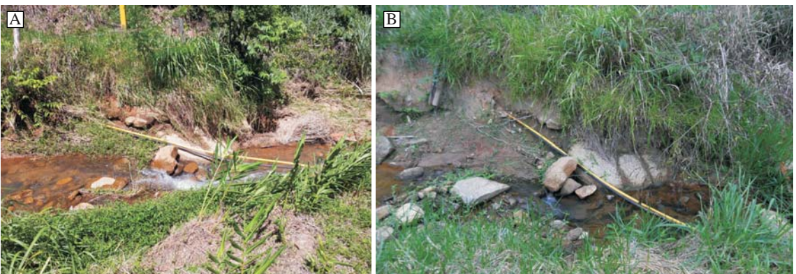
Figura 3: Aspecto geral do canal a jusante do duto (a) e detalhe da exposição do cabo de fibra óptica (b)
