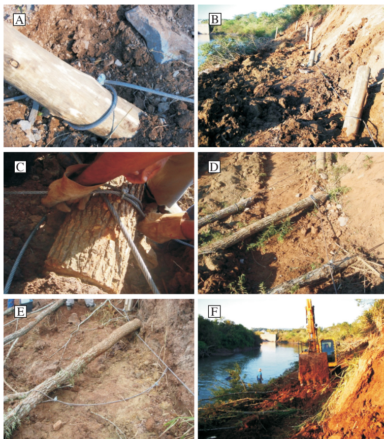
Figura 10: Execução da ancoragem de árvores de Salix humboldtiana . A, B) Pilotos de madeira cravados ao longo do talude interligados por cabo de aço. C, D, E) Árvores de Salix humboldtiana sendo fixadas ao cabo de aço principal por meio de espigas e grampos. F) Aporte de solo para recobrir as árvores ancoradas.
