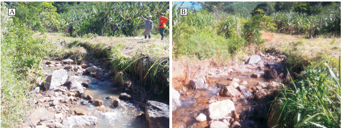
Figura 4: Aspectos do canal a jusante do duto. As imagens A e B mostram um canal relativamente estreito e bem demarcado, taludes com inclinação acentuada e rochas de grandes dimensões. Essas características são típicas em torrentes de montanha.
