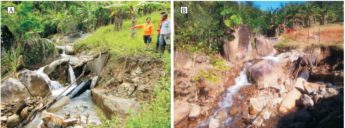
Figura 3: Aspectos do canal junto ao duto. As imagens A e B mostram um canal alterado pela energia do fluxo da água. Leito e margens escavados, fragmentos de rochas de grandes dimensões arrastados e margens com inclinações acentuadas. A estabilidade da faixa foi prejudicada e a segurança do duto, exposto juntamente com a fibra óptica, poderia ser comprometida se o processo persistisse.
